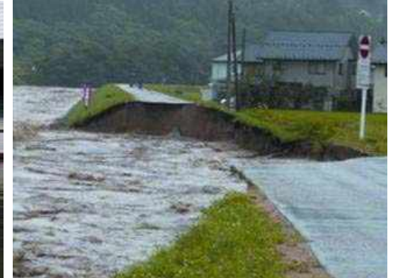
H18.7災害 堤防決壊(箕輪町松島地区)
