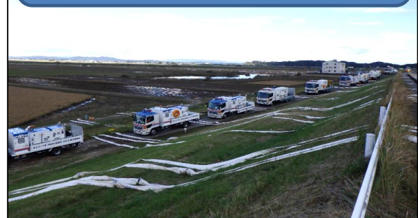
宮城県大崎市の浸水箇所での排水作業 (全国から集まった排水ポンプ車・照明車)
