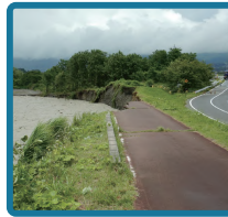
令和2年 三峰川堤防の欠損
