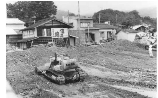
埋まった土砂の災害復旧作業(伊那市沢渡)
