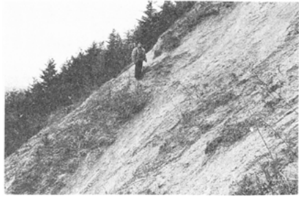
写真13 昼神断層より梨子野山側には崩壊が多発し、砂のように崩れている。
