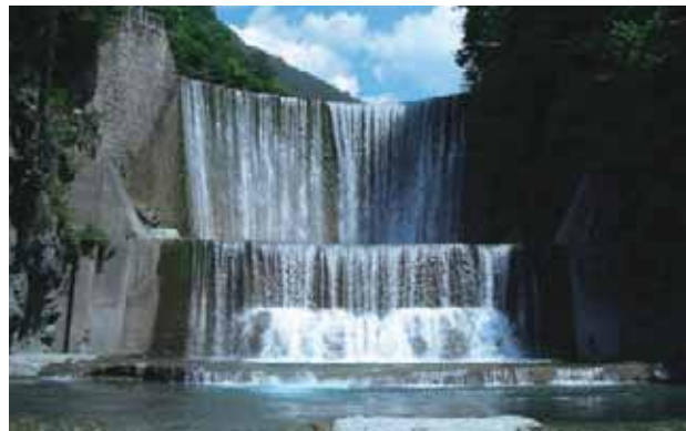
上蔵砂防堰堤(小渋川本川)
