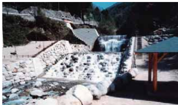
人工滝を採用した中御所第2砂防堰堤(太田切川支川中御所川)
