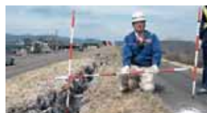
堤防被災調査 (H23.3 東日本大震災)
