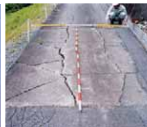
地すべりによる陥没で亀裂の入った道路
