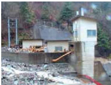
平成15年4月太田切川で発生した土石流により土砂で埋まった発電所施設
