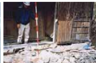
平成4年の被害 地すべりで地盤が沈下したため、民家の敷居にすき間ができてしまいました。
