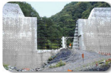
ネット付スリット型砂防えん堤 (尾勝谷第3砂防えん堤: 三峰川水系) 洪水時には土石流や流木をせき止め、平常時には徐々に土砂を流します。ネットは流木捕捉に速し維持管理も容易で、低コストを可能にしました。
