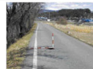
堤防の陥没(写真中央ポール部分)
