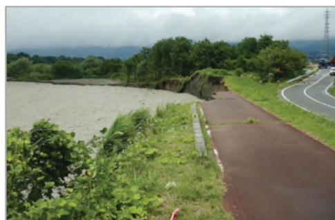
堤防の欠損（R2. 7. 1）
