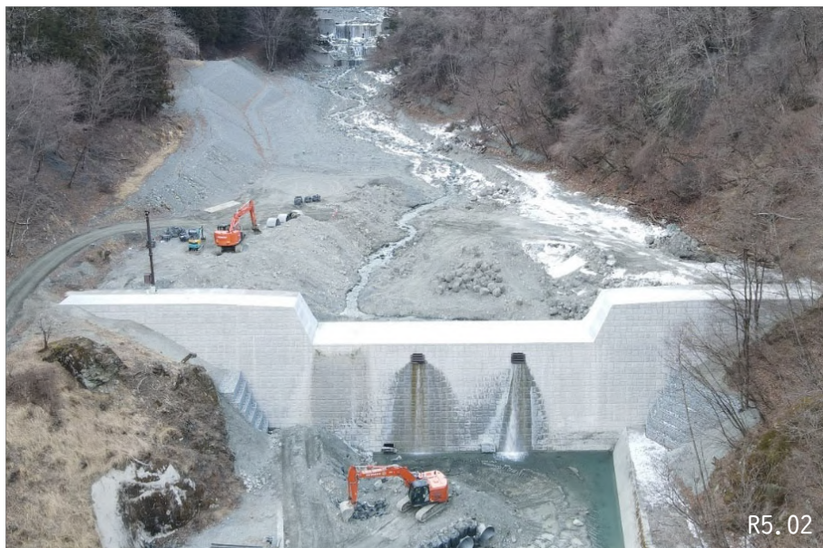
手開沢砂防堰堤
