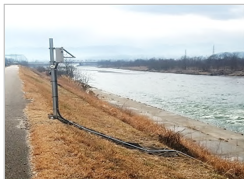
危機管理型水位計の設置状況
