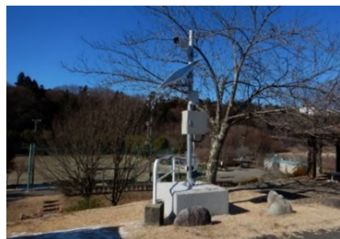
簡易型河川監視カメラの設置状況
