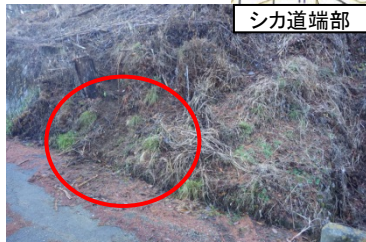
端部に土壌の流出痕が見られる
