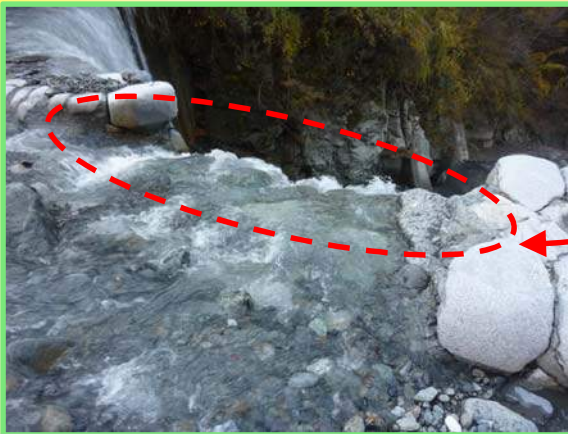
堰堤の上から見たところ (石が剥がれている)
