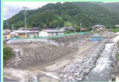
平成27年度 天竜川水系 塩川床固工群工事 施工者：大協建設株式会社
