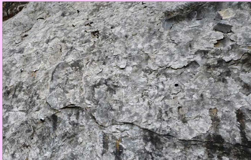
法面吹付モルタルのはがれ・浮き上がり
