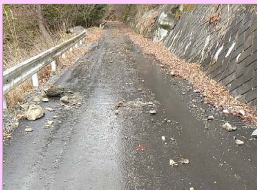
工事用道路の落石状況
