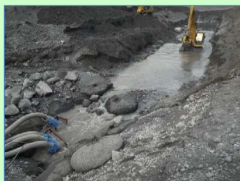
大量に発生した掘削中の湧水
