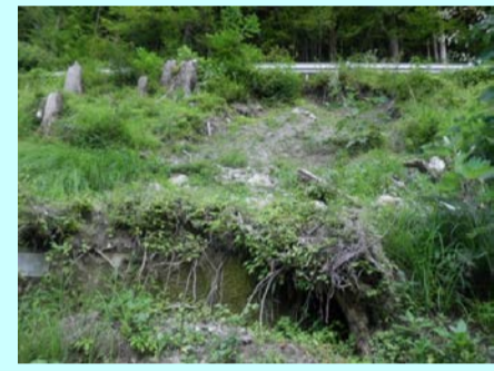
横ボーリング施工箇所の変状
