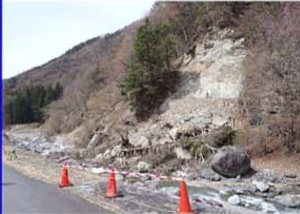
崩落土砂撤去前
