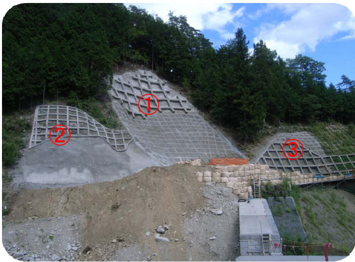
伊ノ木沢砂防堰堤左岸崩落法面
