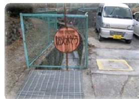
防火水槽の腐食と蓋の損傷
