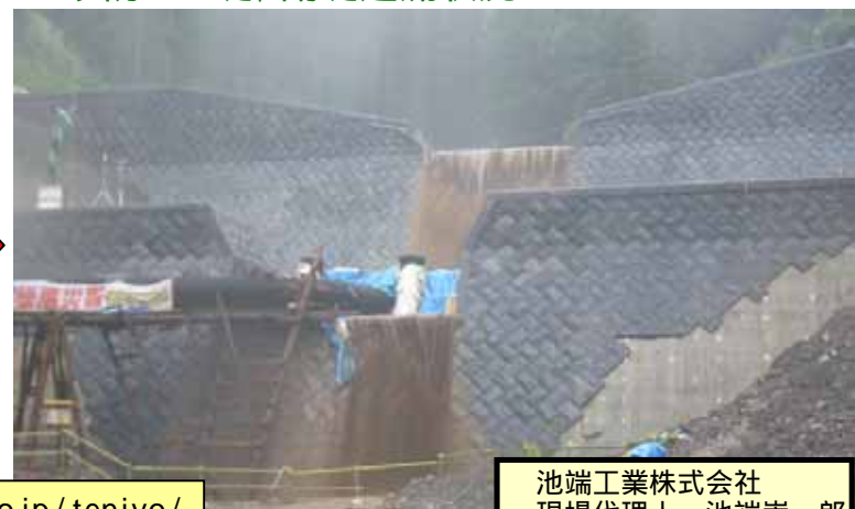
砂防えん堤、副堤越流状況
