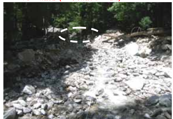
えん堤上流部(土石流発生後)
