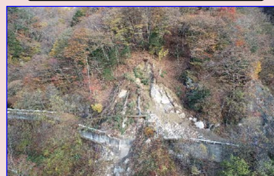
法面崩落箇所 空撮状況
