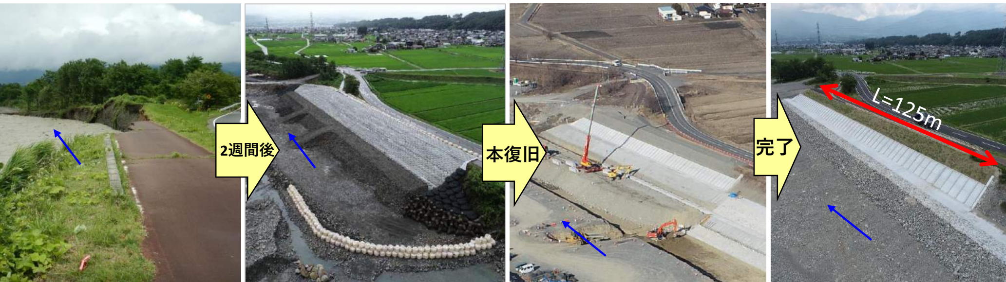
令和2年 7月1日 8:00 堤防の欠損状況の確認
