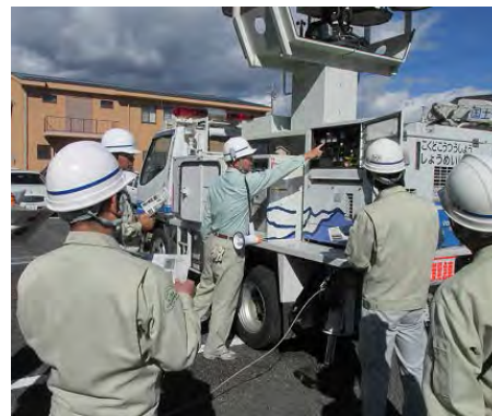
照明車(10m級)発電気制御盤の操作
