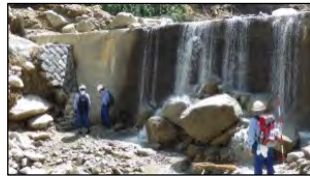
【被災状況調査】
