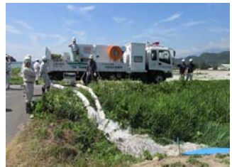
ポンプ排水状況
