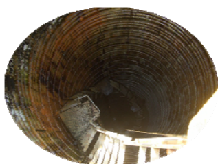
深さ40mの集水井
