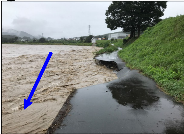
8月15日10:00 管理用通路の欠損状況
