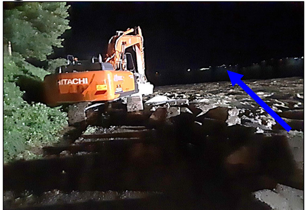
8月15日21:00 応急復旧状況(欠損箇所)
