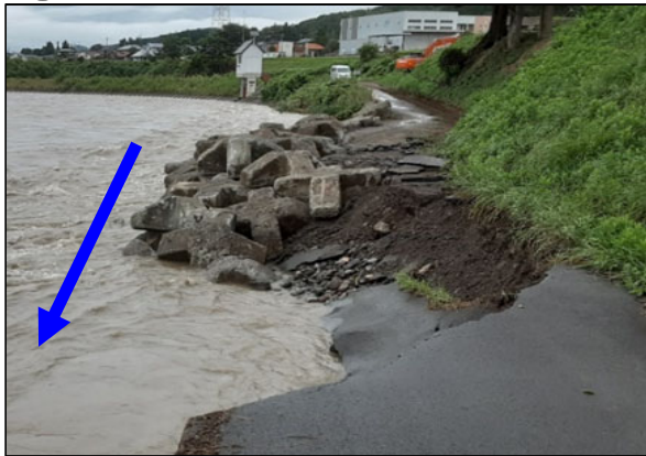
8月16日6:00 応急復旧状況(欠損箇所)
