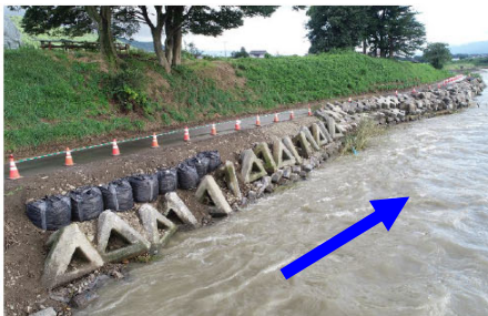
欠損箇所上下流での河岸侵食を防ぐため補強工事を行いました。
