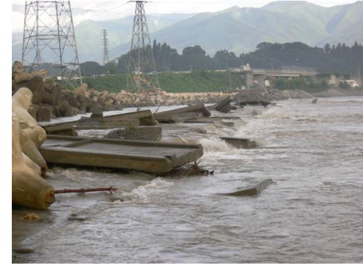
④護岸被災状況
