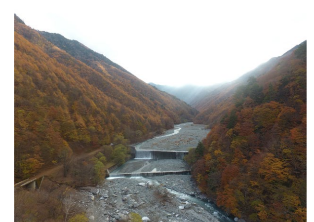
写真 令和元年台風19号による洪水時に土砂・流木を捕捉した小瀬戸第1砂防堰堤(三峰川本川上流部)
