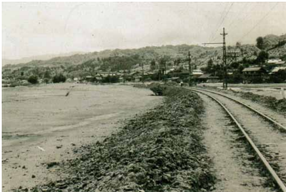
飯田線、復旧工事の現場 線路東側は日本三大桑園とも言われた桑畑だったが、泥で埋まってしまった
