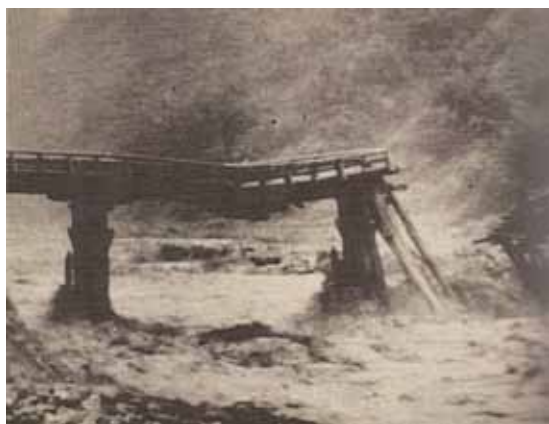
鹿塩川の増水で落ちた橋
