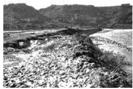
決壊した小和田の堤防
