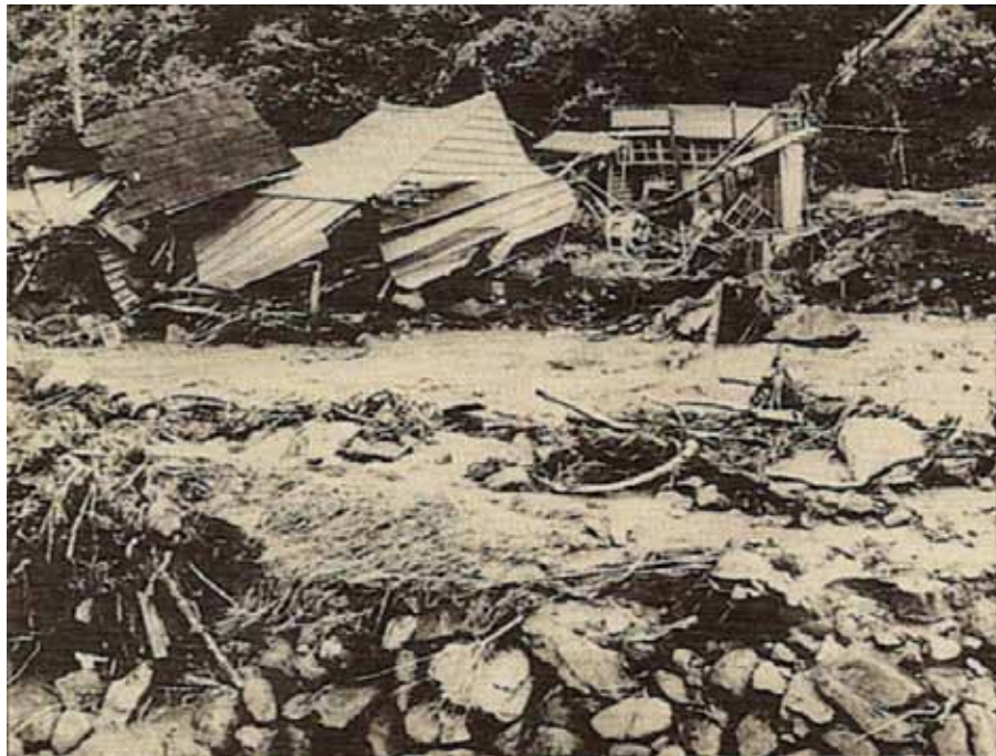
全壊した上割新宮川発電所
