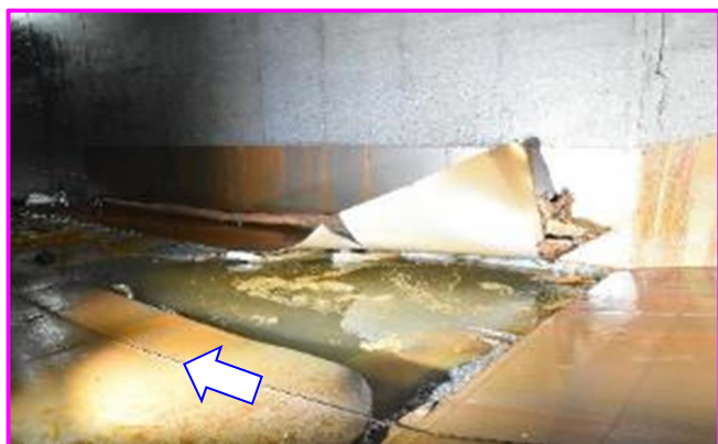
保護工 損傷状況
