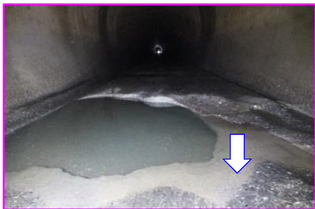
インバートコンクリート 損傷状況
