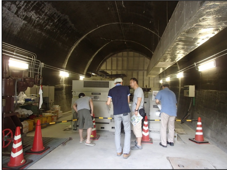
小渋第3発電所見学
