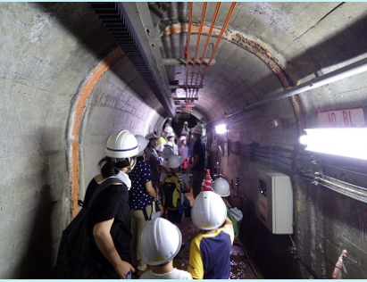
美和発電所内部
