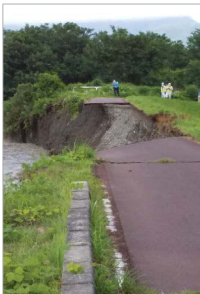
7月1日8:00 堤防の欠損状況の確認
