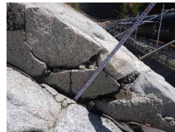
右岸側護岸の被災状況(浮き上がり)
