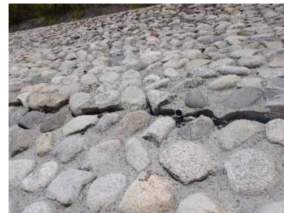
右岸側護岸の被災状況(亀裂)
