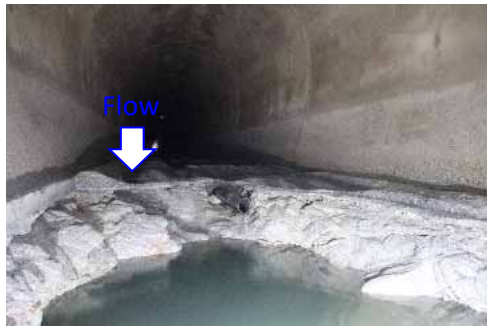
バイパストンネル内の摩耗状況
