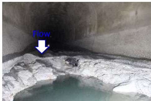
バイパストンネル内の摩耗状況
