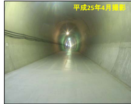
写真 トンネル内部 (覆工コンクリート・インバート本体工完了)
