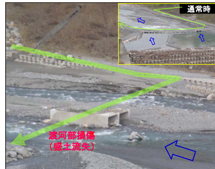
渡河進入路の流失状況
