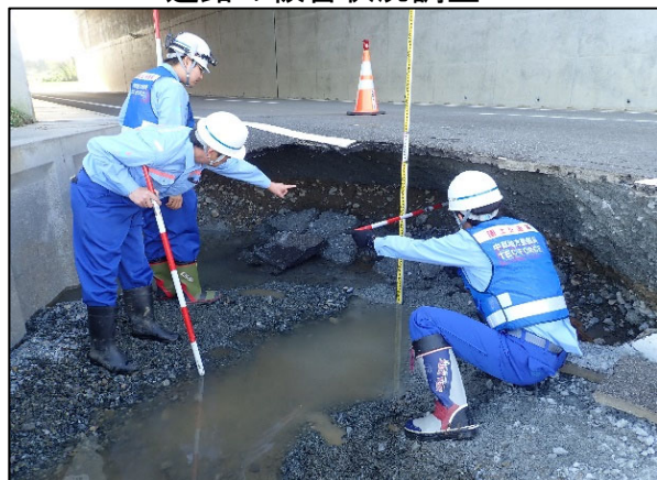
道路の被害状況調査
