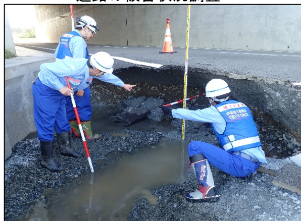
道路の被害状況調査
