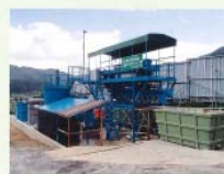
濁水処理設備
