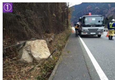
H25.11.27に発生した落石状況
