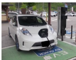
EV充電施設
