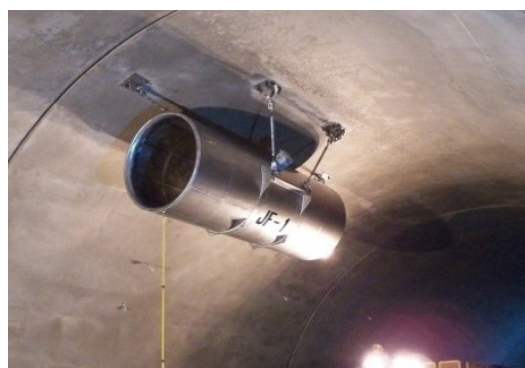
トンネルジェットファン 〔トンネル内の有害物質を排気し 新鮮な空気を取り込む機器〕
