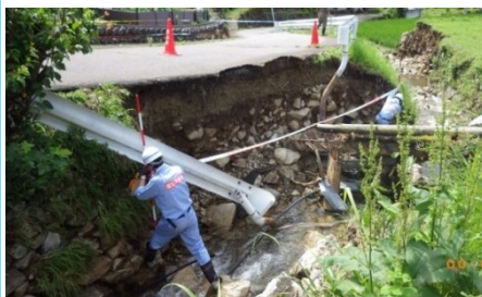
河川の被害状況調査(下呂市)
