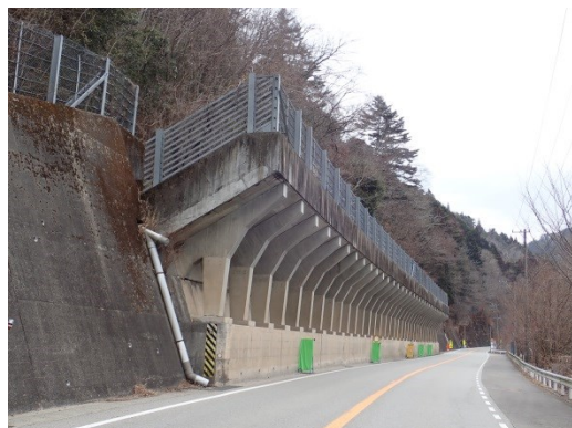
落石防護施設
