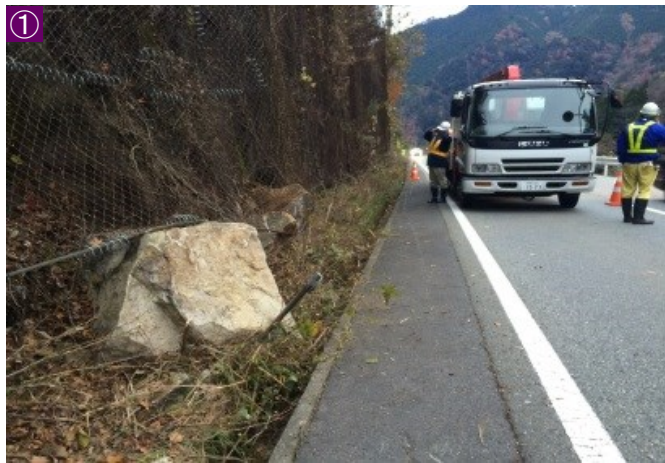
平成25年11月27日に発生した 落石状況
