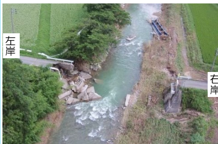
宮前橋が落橋し、左岸3世帯が孤立
