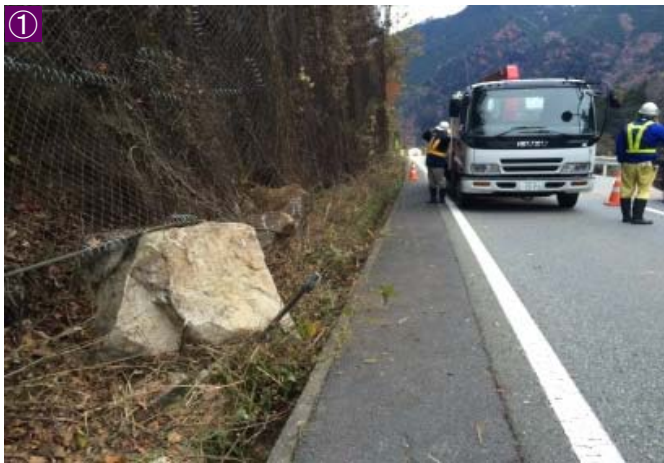
平成25年11月27日に発生した 落石状況
