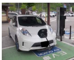
EV充電施設
