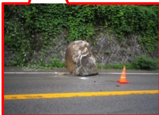
平成25年7月7日落石事故発生
