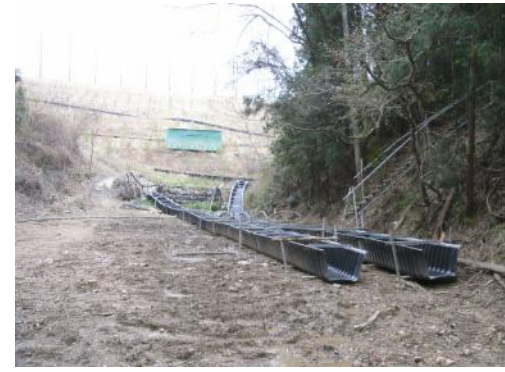
排水管（調整池側）
