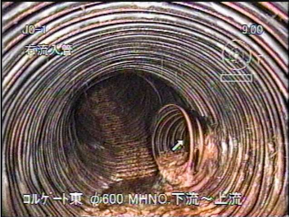
写真-2 出口から 9.0m 付近 (φ 300 枝管からの浸出水の状況)
