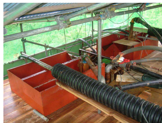
浸出水の水量観測設備
