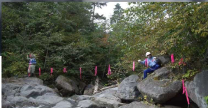
ワイヤーセンサーの設置状況
