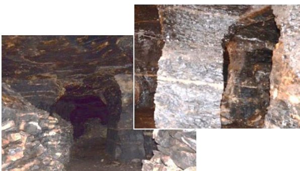
亜炭採掘跡(廃坑内部の様子)
