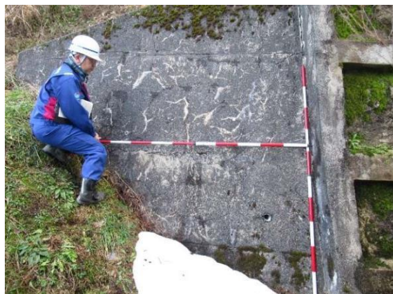
急傾斜地の被災状況調査
