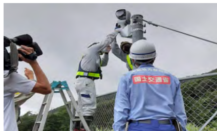
源頭部WEBカメラ設置
