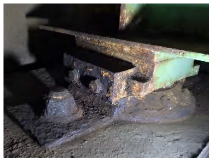
損傷部位の確認
