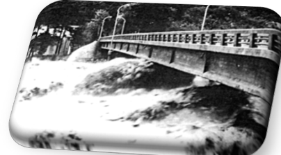
南木曽橋の主桁にせまる濁流 〈出典：「中部の水害」〉
