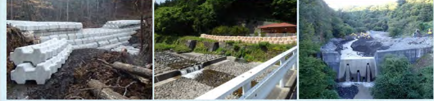
コンクリートブロック積み砂防堰堤（鹿ノ瀬川、国土交通省中部地方整備局） 大型土のうによる護岸の高上げ（鈴ヶ沢、長野県） 砂防堰堤の除石（湯川、長野県）
